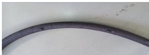
Рис. 1. Рукав высокого давления с видимыми участками вздутия
